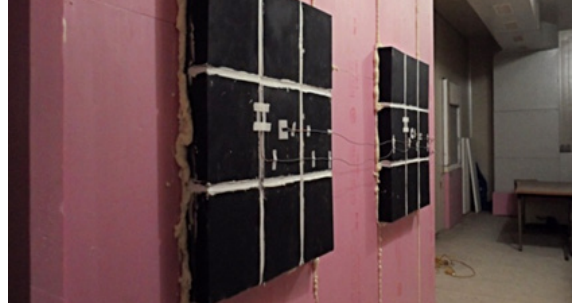
저온실(외부) 센서 설치 (영하 8.5℃)
